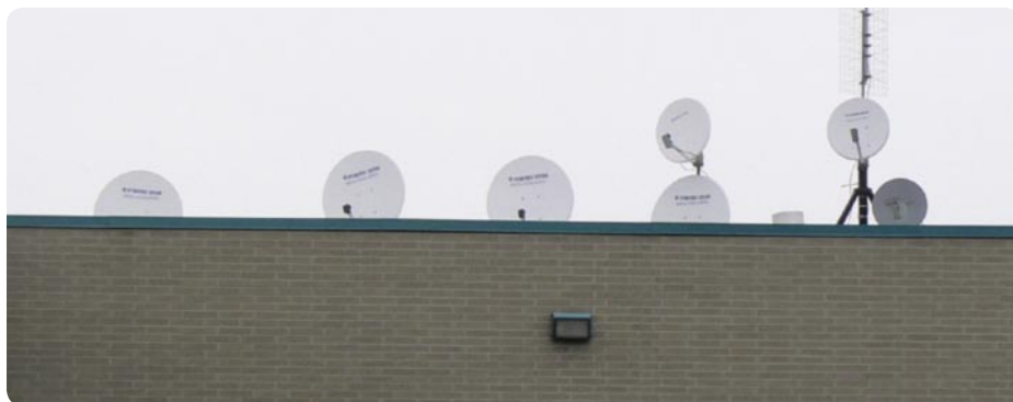
Prijemne antene Fortec Stara jedva su vidljive na krovu zgrade. Dvije antene na lijevoj strani su modeli od 90 cm, pri čemu prvu pokreće motor STAB HH90, a drugu STAB HH120.
