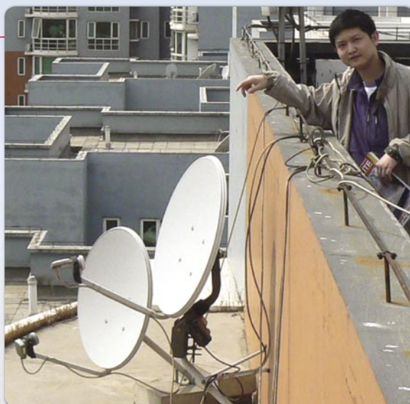
■ Dodatne antene postavljene na bočnu tračnicu: antena od 75 cm usmjerena je prema 134° istočno, dok onom od 60 cm upravlja MOTECK motor.
